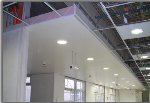
FOTO No.33. Ejemplo de instalación de cielo raso.
