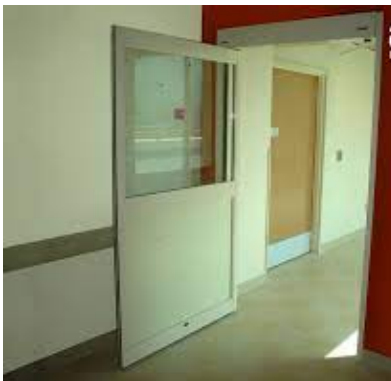
FIGURA No.42. puerta de abierta para ventilar.
