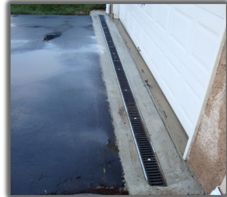
FOTO No.25. Ejemplo de rejilla de varilla instalada.
