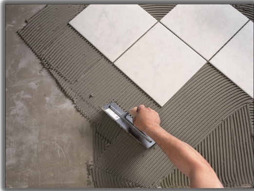
FOTO No.18. ejemplo de revestimiento cerámico.
