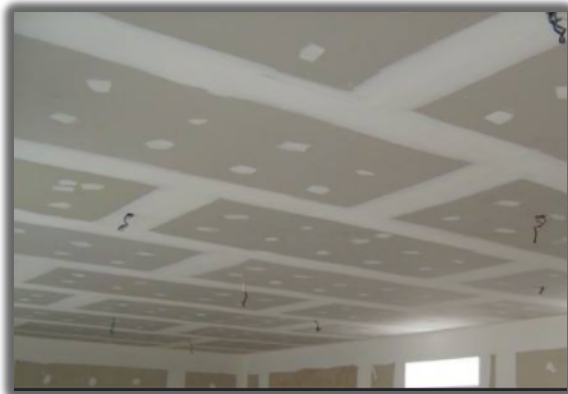
FOTO No.32. Ejemplo de instalación de cielo raso.
